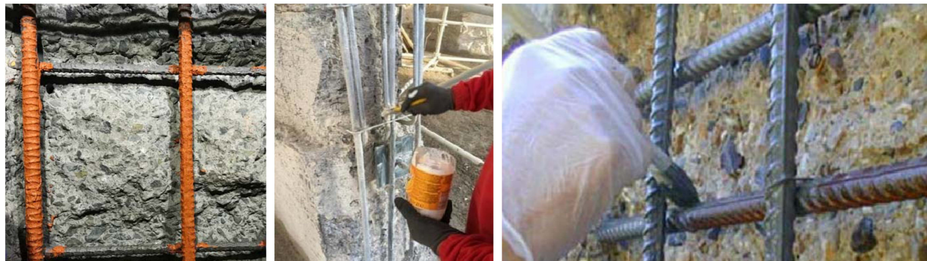
TE BEHT LYERJA ME BOJE KUNDER KORROZIONIT (NDRYSHKJES)
